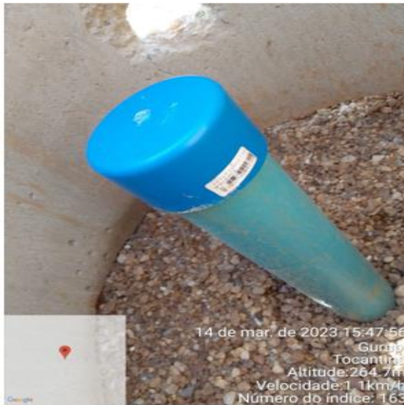
Figura 4 POÇO PIEZOMETRO TAMPADO
